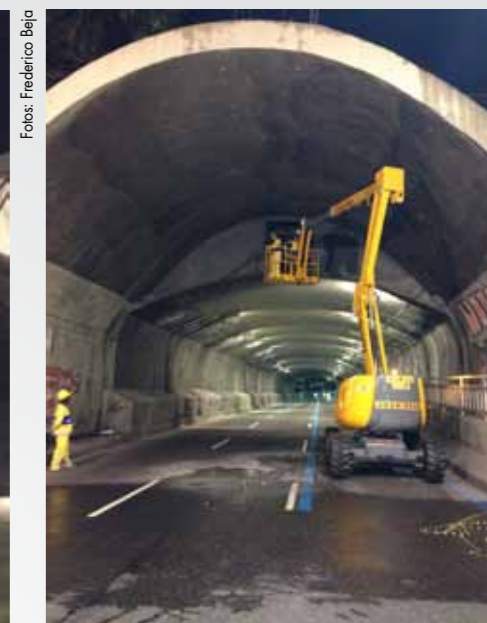
Desde a preparação até a finalização da passarela do interior do túnel o cuidado e a qualidade do trabalho estiveram presentes
