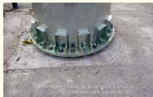
Detalhe da concretagem, com destaque para o gabarito para a montagem do poste
