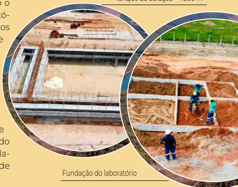
Tanque de aeriação – 4800 m 3
