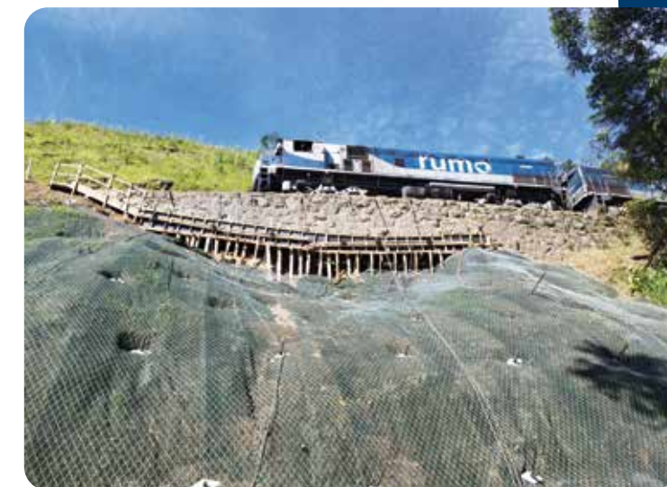
O trem cruzando a linha de ferro em meio ao trabalho na obra
